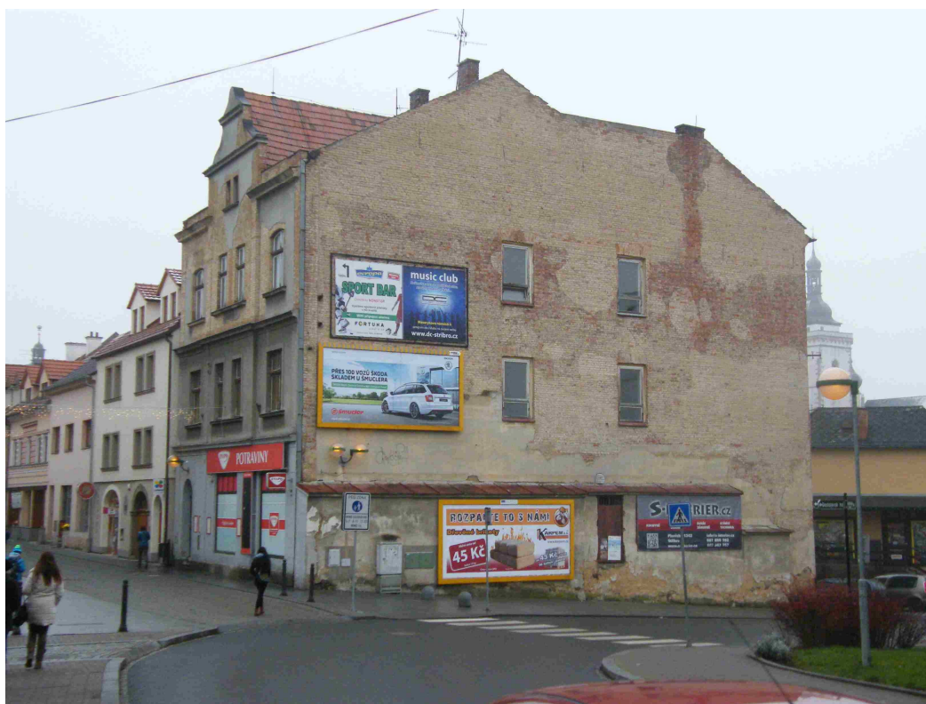
Neutěšený stav nemovitosti č.p. 193
